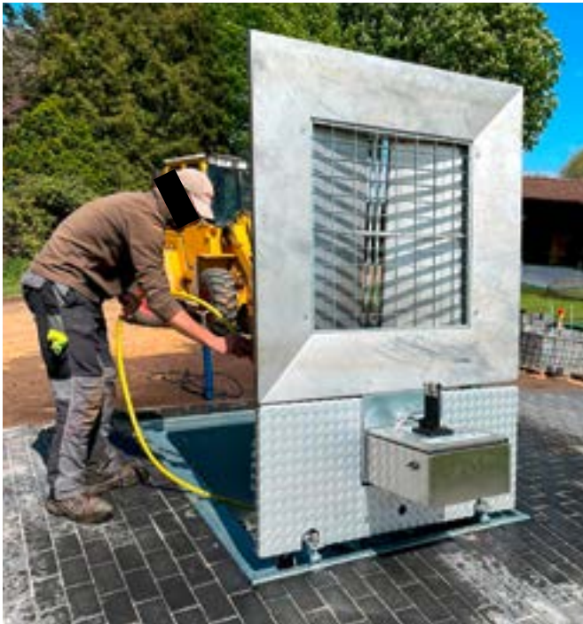
Betriebsfertig installiert, steht das vollautomatisierte Golfballmanagementsystem am gewünschten Platz zur Verfügung.
